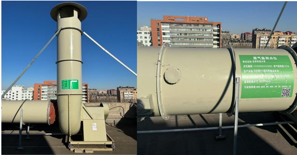
图 4 实验室废气处理设施及废气排放口
